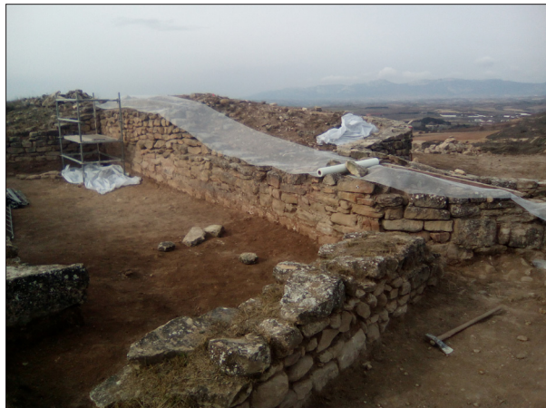
Malla de fibra de vidrio sobre la línea de remate de las camisas de sillarejo. Campaña de 2018/2019.
