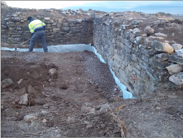
Forro de geotextil y repleción con gravilla de la zanja de drenaje en el sector septentrional. Campaña de 2018/2019.
