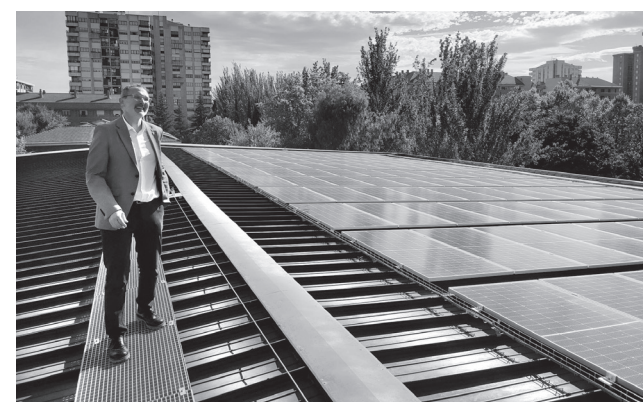
■ El concejal de Deportes visita la nueva instalación de paneles solares en el tejado de Lobete.
